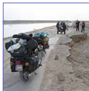
Delar av vägen är bortspolad
